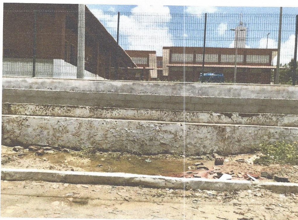
Acúmulo de água devido o carreamento no solo por confinamento abaixo da fundação do muro
