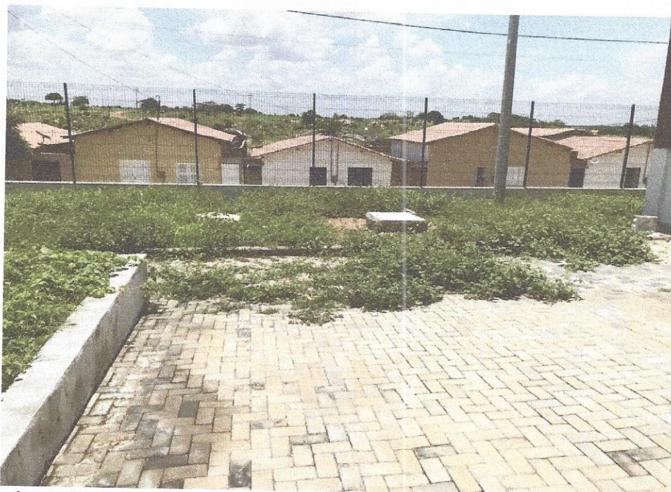
Conjunto fossa/sumidouro se encontra muito próximo do muro de contenção
